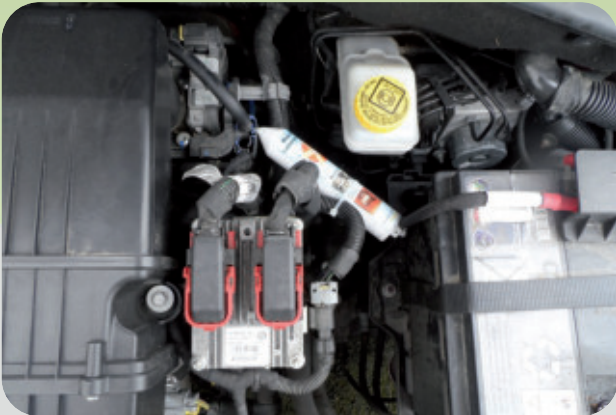
Weber-Isis®-Universal-Aktivator Montage im Motorraum an der Benzinleitung eines Fiat Punto.
